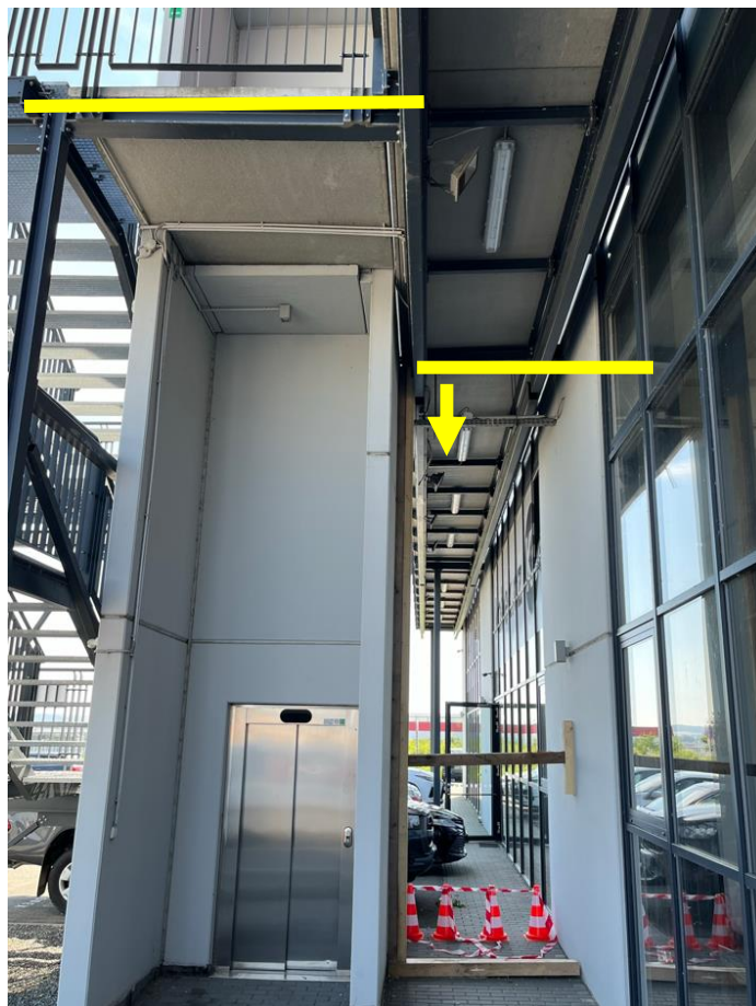
Obr. 31 Svislá deformace a naznačený pokles v místě poruchy přípoje
