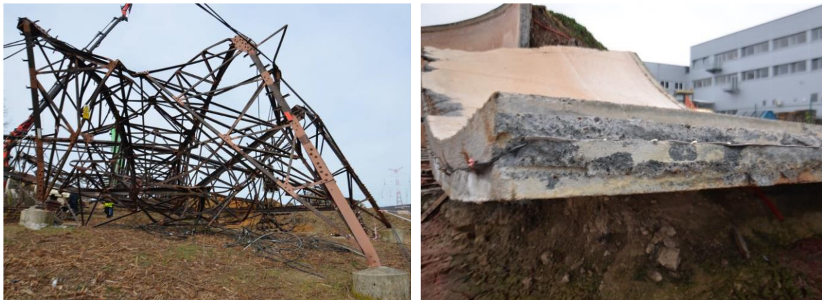
Obr. 4 Hrubé chyby mohou vést k havárii stavby – vlevo kolaps stožáru vysokého napětí při nesprávném postupu demontáže elektrického vedení, vpravo kolaps části nádrže ČOV po nesymetrickém odstranění části zeminy
