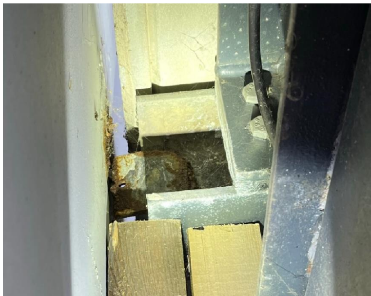
Obr. 32 Oddělený přípojný plech od zabetonované desky ve výtahové šachtě (druhý přípojný plech již s konstrukcí není spojený). Dočasné podepření dřevěnými sloupky
