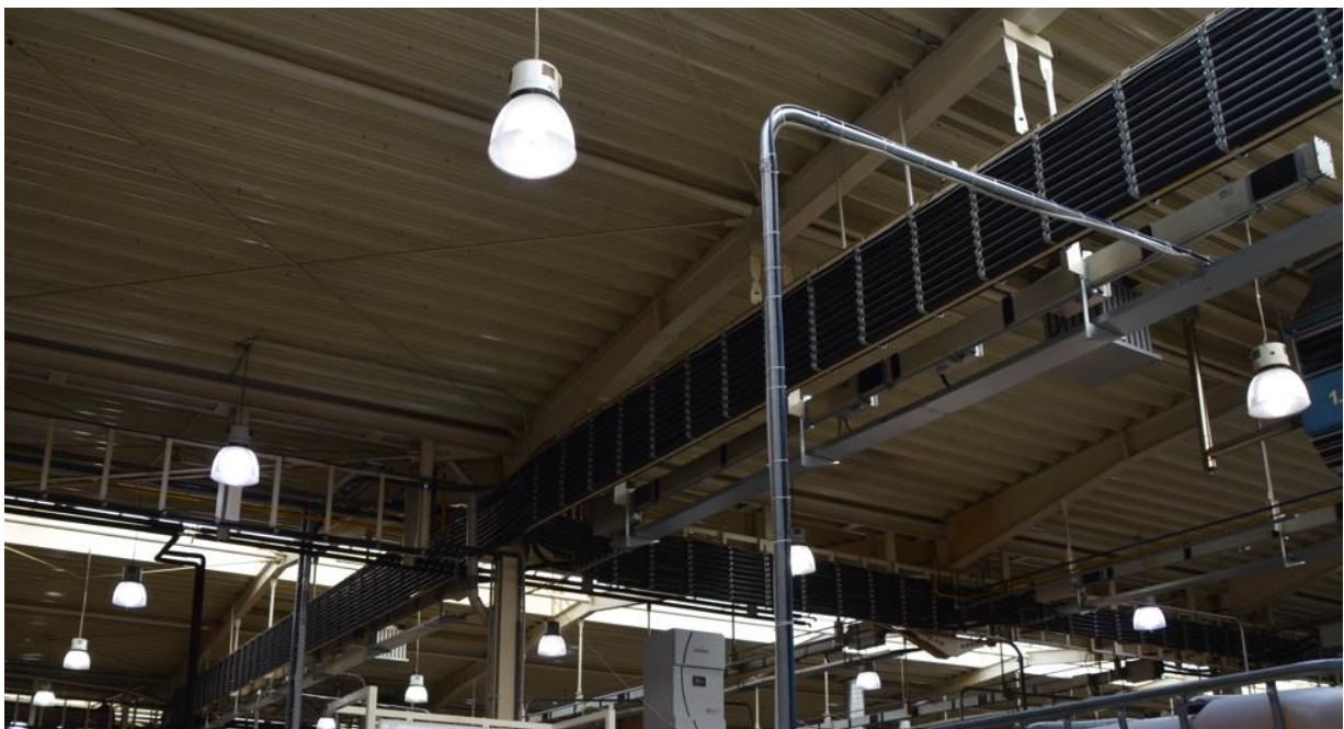
Obr. 10 Přetížení technologickými rozvody
